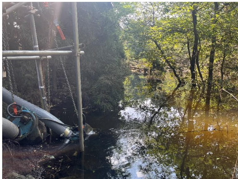
閉塞した調整池のポンプ排水状況
